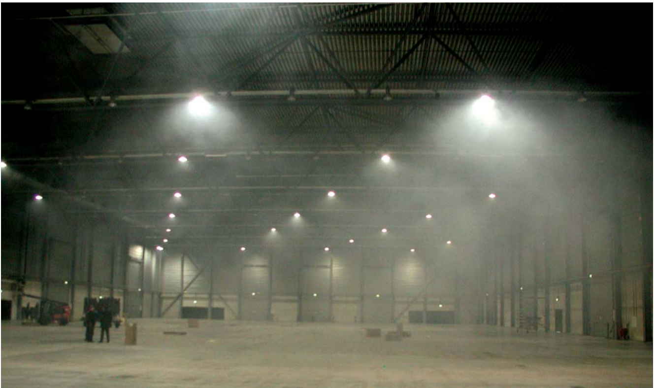
1. De Brabanthallen in Den Bosch, waarbij het luchtdistributiekanal voorzien van plenums met inblaasnozzles aan één zijde van de hal is gesitueerd. Met rookgeneratoren is de doorspoeling getest.
